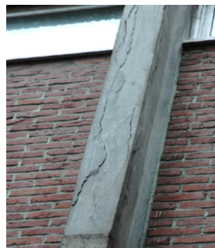
FIGUUR 20: LOSZITTENDE STUKKEN BETON KUNNEN DE VEILIGHEID VAN VOORBIJGANGERS IN HET GEDRANG BRENGEN
