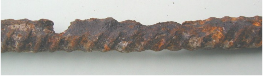
FIGUUR 9: PUTCORROSIE, VEROORZAAKT DOOR CHLORIDEN
