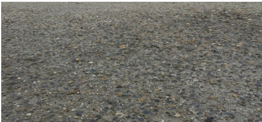
FIGUUR 5: EEN BETONVERHARDING, AANGETAST DOOR VORSTSCHADE IN AANWEZIGHEID VAN DOOIZOUTEN
