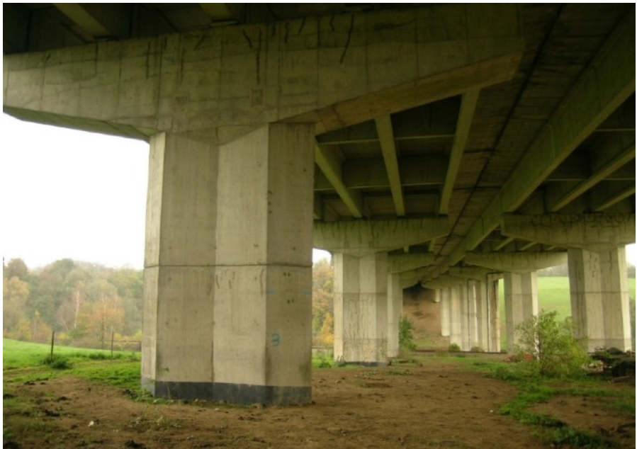
FIGUUR 3: EEN BETONCONSTRUCTIE, GETROFFEN DOOR DE ALKALI-SILICAREACTIE
