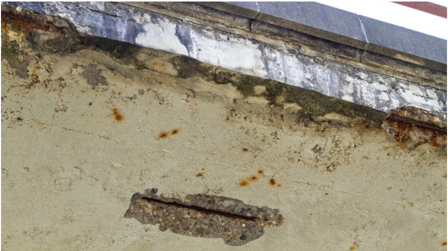
FIGUUR 10: ROESTSPOREN AAN HET BETONOPPERVLAK
