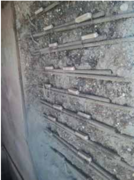
De kathodebescherming vrijwaart de metaalarmaturen van het gewapend beton van corrosie. (foto Fereb)
