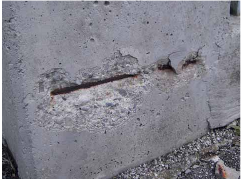
De “carbonatatie” wordt als “betonkanker” beschouwd: ze tast gewapend beton aan en legt de wapening bloot. (foto Blog e-devis.ch)
