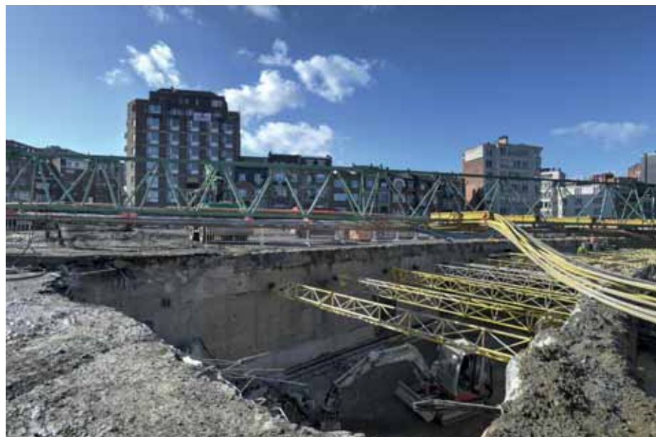
Gebouwen en bouwwerken die veertig tot vijftig jaar geleden tot stand kwamen, beginnen nu ernstige tekenen van beschadiging te vertonen, zoals hier de Reyers-Meisertunnel. (foto Brussel Mobiliteit)
