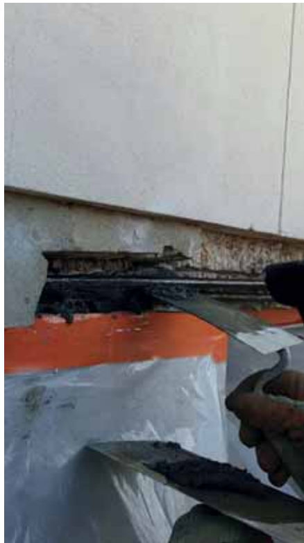
Vóór herstellingen uitgevoerd kunnen worden aan een betonconstructie moeten eerst de oorzaken van het probleem achterhaald worden en dient de juiste diagnose te worden gesteld. (foto Fereb)
