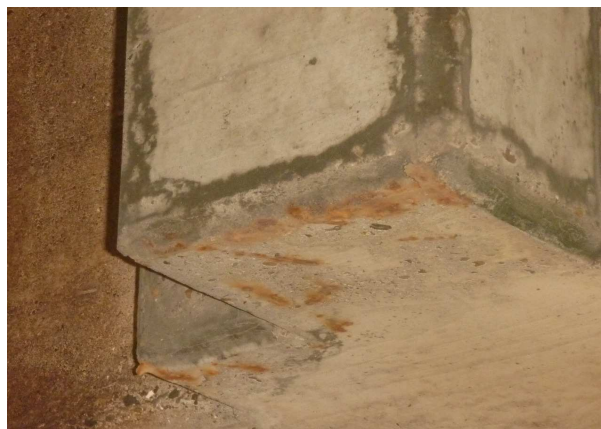
PHOTO 10: pas de dégât dû aux chlorures (ligature)
