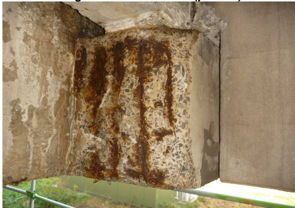
PHOTO 5: dégât dû aux chlorures (viaduc joint fuyant)
