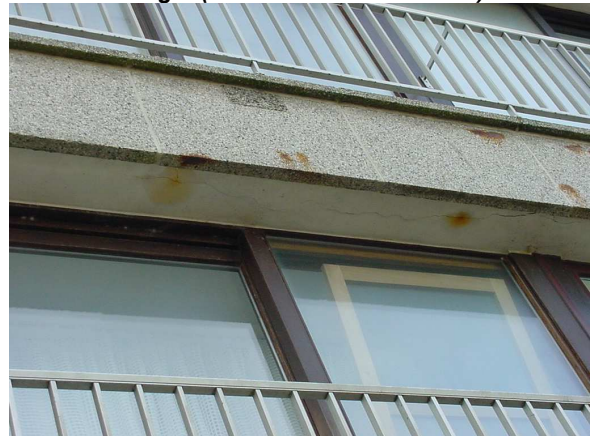
PHOTO 6: dégât dû aux chlorures (maritime panneaux préfabriqués)
