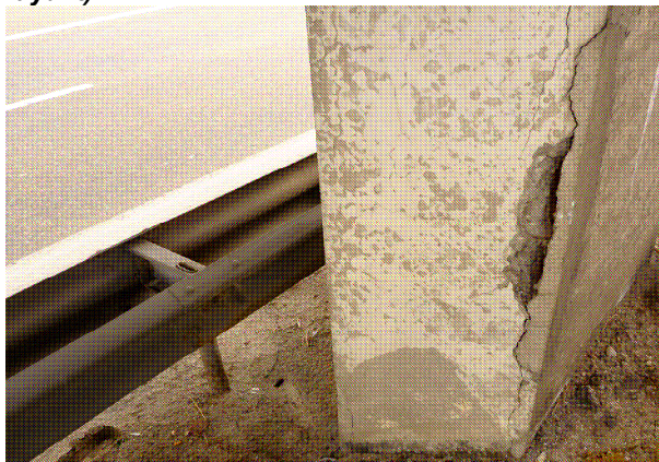
PHOTO 7: dégât dû aux chlorures (sels d'épandage)
