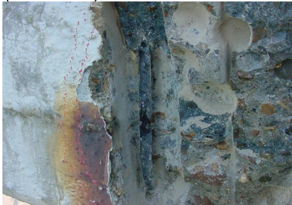
PHOTO 3: dégât dû aux chlorures (piscine)
