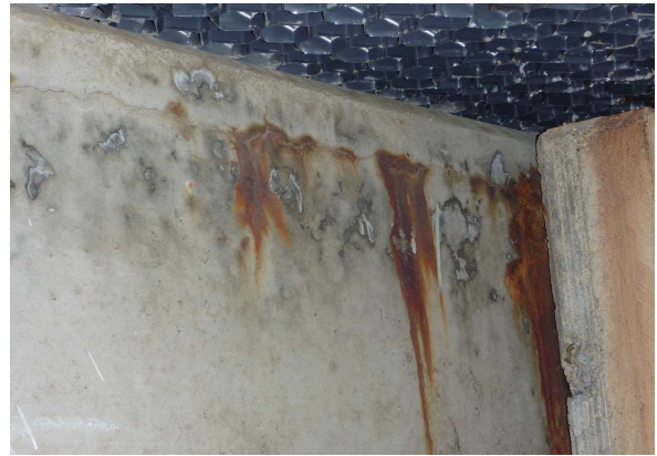
PHOTO 4: dégât (tour de refroidissement)
