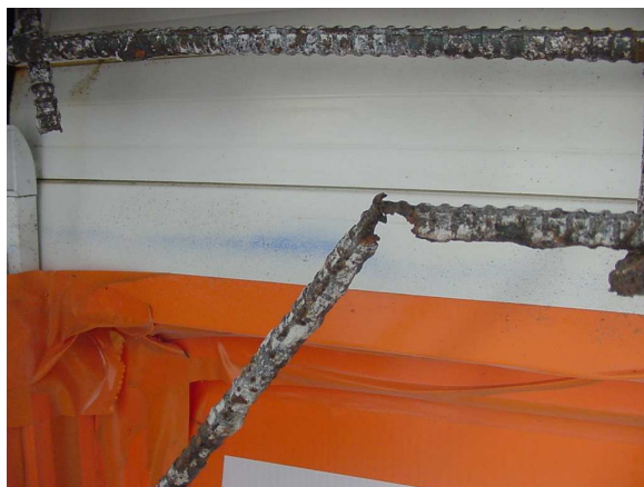
PHOTO 9: dégât (région maritime piqûre)
