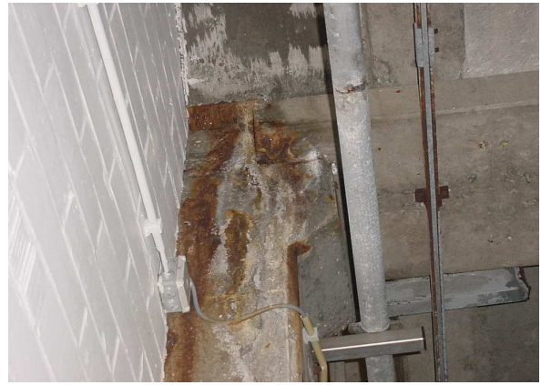
PHOTO 2: dégât dû aux chlorures (industrie)
