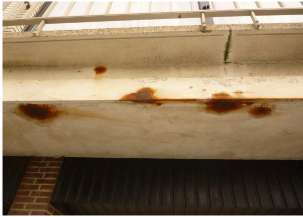
PHOTO 1: dégât dû aux chlorures (climat maritime)
