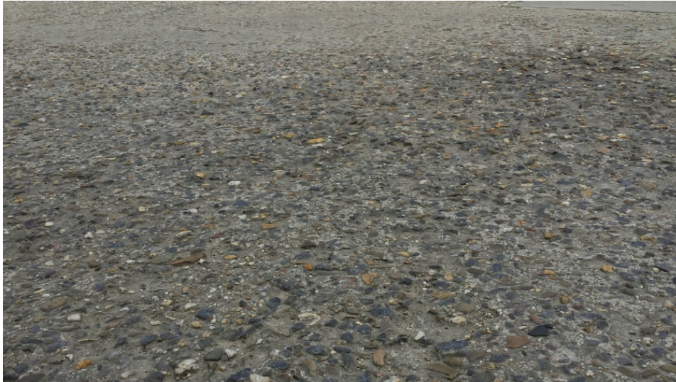
Figuur 5: Een betonverharding, aangetast door vorstschade in aanwezigheid van dooizouten
