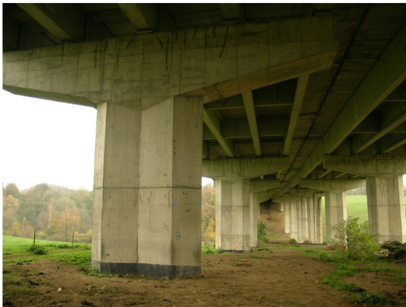
Figuur 3: Een betonconstructie, getroffen door de alkali-silicareactie
