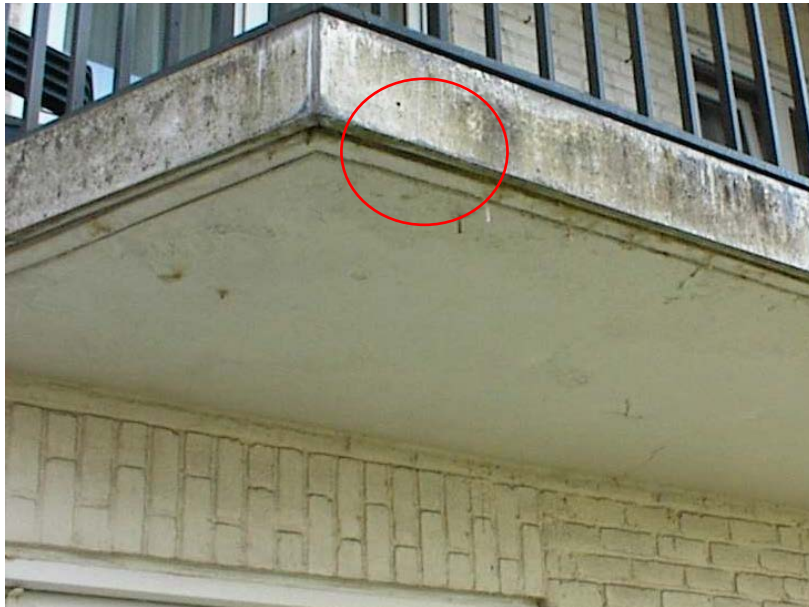
Figuur 4: Stalactietvorming onderaan een balkon
