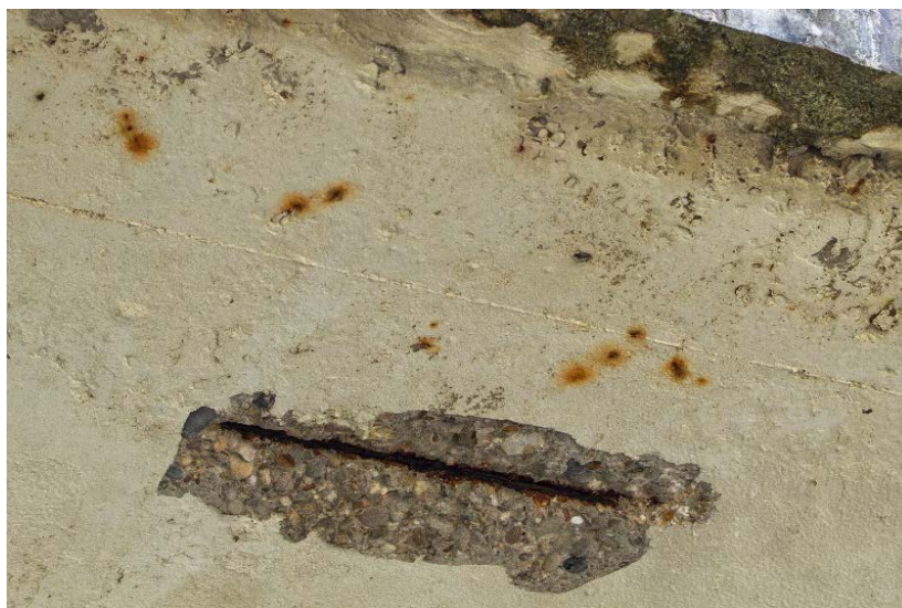
Figuur 10: Roestsporen aan het betonoppervlak
