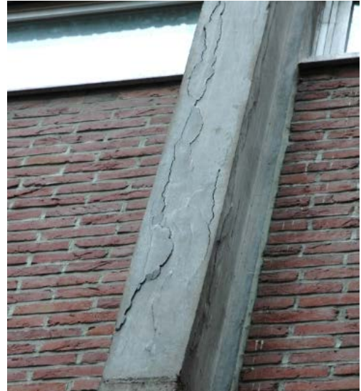
Figuur 1: Loszittende stukken beton kunnen de veiligheid van voorbijgangers in het gedrang brengen
