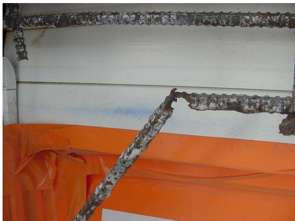
FOTO 9: chlorideschade (zeeklimaat - putcorrosie)
