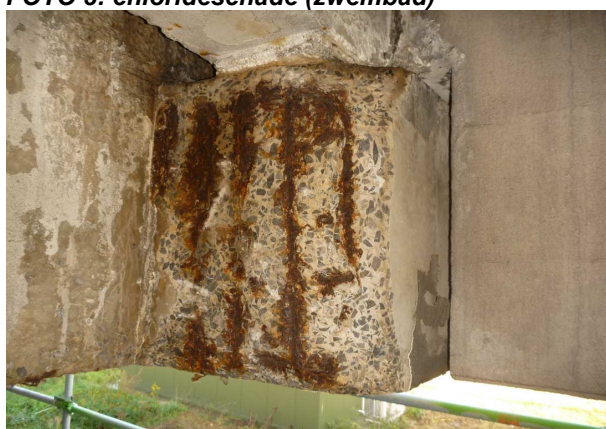
FOTO 5: chlorideschade (lekkende voegen viaduct)
