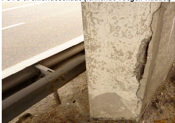
FOTO 7: chlorideschade (pijlers brug - dooizouten)
